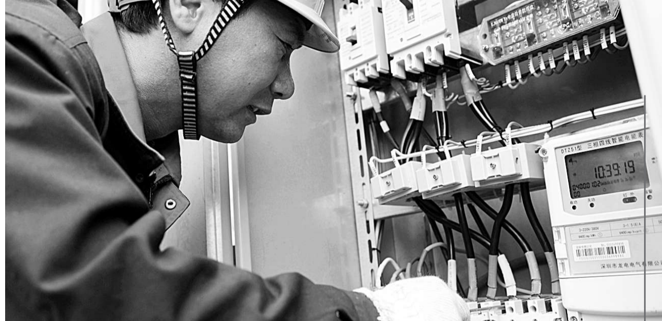
近日，河北承德首个“个人发电厂”投入使用。市民朱凤喜在自家经营的农家内建造的分布式光伏发电系统，这套系统共180块光伏板，日发电量预计160—180千瓦时，除自用的40%外，余电可并入国家电网。图为7月10日，国家电网冀北承德供电公司工作人员在朱凤喜的农家内检修低压配电设施。
