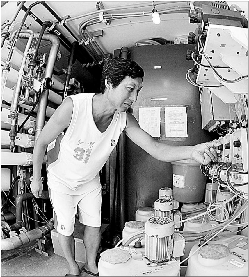
随着三沙设市一周年临近,三沙市永兴岛各项工程也开始加快建设。来自全国各地的能工巧匠加班加点,为建设三沙人民南海幸福家园而努力。图为技术人员在对永兴岛海水淡化设备进行维护。新华社记者 郭程摄
