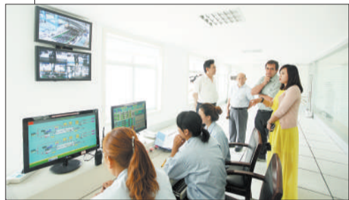
运行现场中控室
