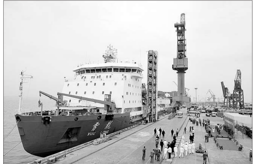
4月16日,“雪龙”号极地科学考察船停靠在江南造船公司码头。当日,“雪龙”号极地科学考察船恢复性维修改造项目在江南造船公司正式开工。工程人员将对船上的动力、甲板机械、环保等“心脏系统”进行恢复性维修改造,预计今年9月份完工。新华社记者 张建松摄
