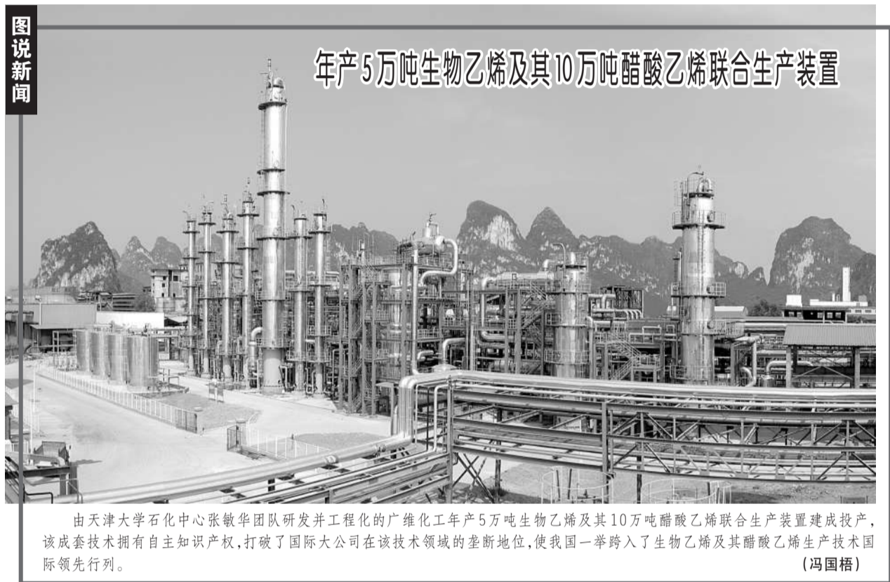
年产5万吨生物乙烯及其10万吨醋酸乙烯联合生产装置 由天津大学石化中心张敏华团队研发并工程化的广维化工年产5万吨生物乙烯及其10万吨醋酸乙烯联合生产装置建成投产,该成套技术拥有自主知识产权,打破了国际大公司在该技术领域的垄断地位,使我国一举跨入了生物乙烯及其醋酸乙烯生产技术国际领先行列。(冯国梧)
