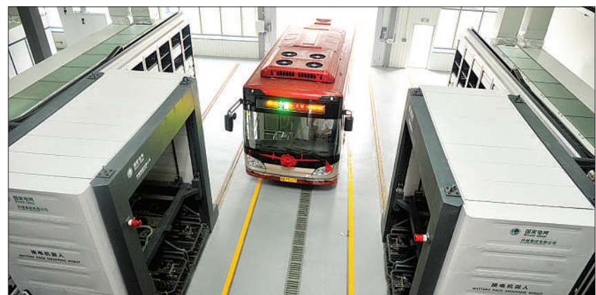
8月8日, 天津市首座电动汽车综合充换电站正式投入运营... 图为车辆进入换电站工位准备进行换电操作。
