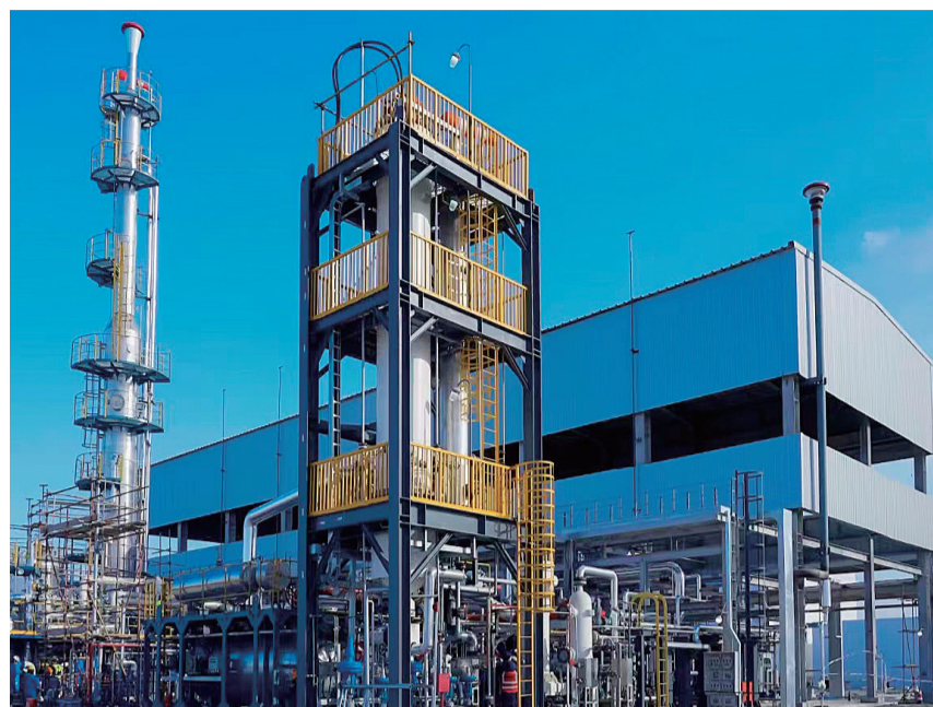
150万吨绿色氢-氨工厂外景。(远景科技集团供图)
