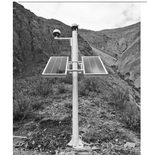
图为安装于云南蒋家沟泥石流试验场的泥石流地声预警仪。（中国航天科工集团三院供图）
