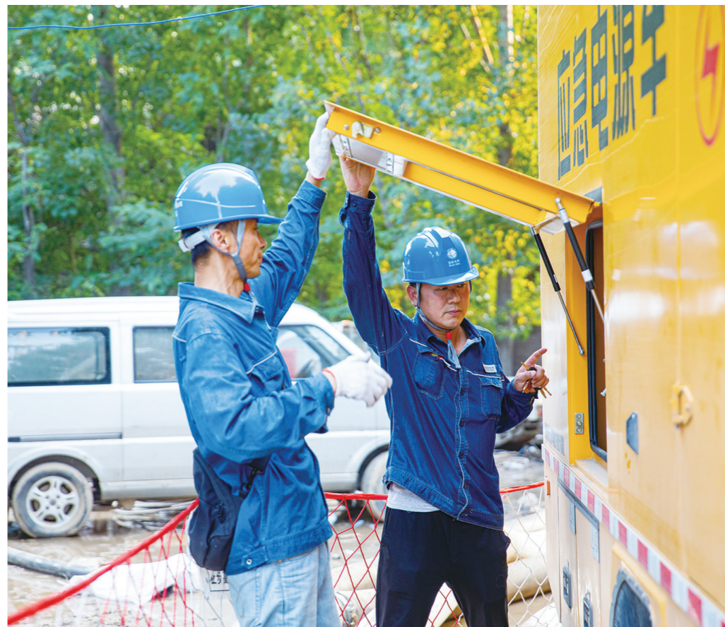
国家电网安徽电力援豫应急发电抢险队淮北分队利用应急发电车为郑州市消防救援支队提供应急电源。
