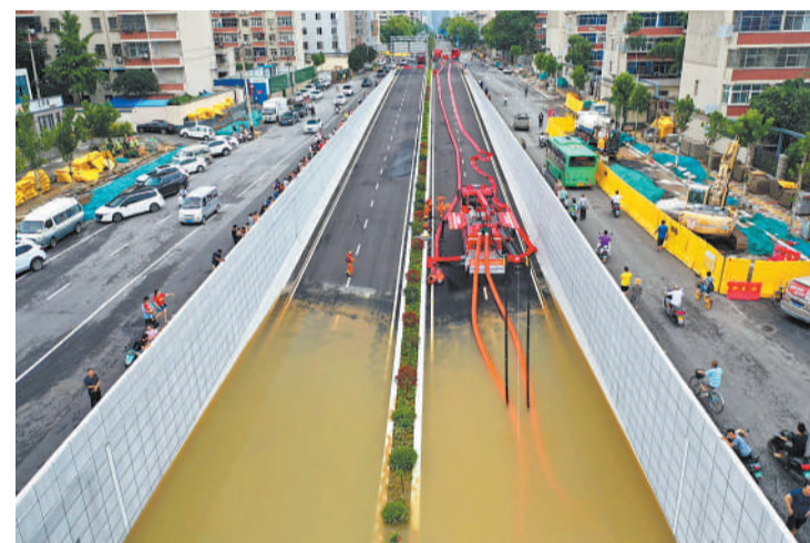
作为河南省郑州市重要的交通通道，暴雨后的桐柏路下穿陇海路隧道严重积水。图为在桐柏路附近拍摄的排涝现场。 新华社发（麻楠然摄）
