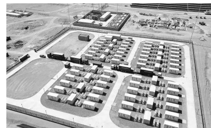
图为全球首个百兆瓦时智能组串式构网型储能项目。中国电力建设集团供图
