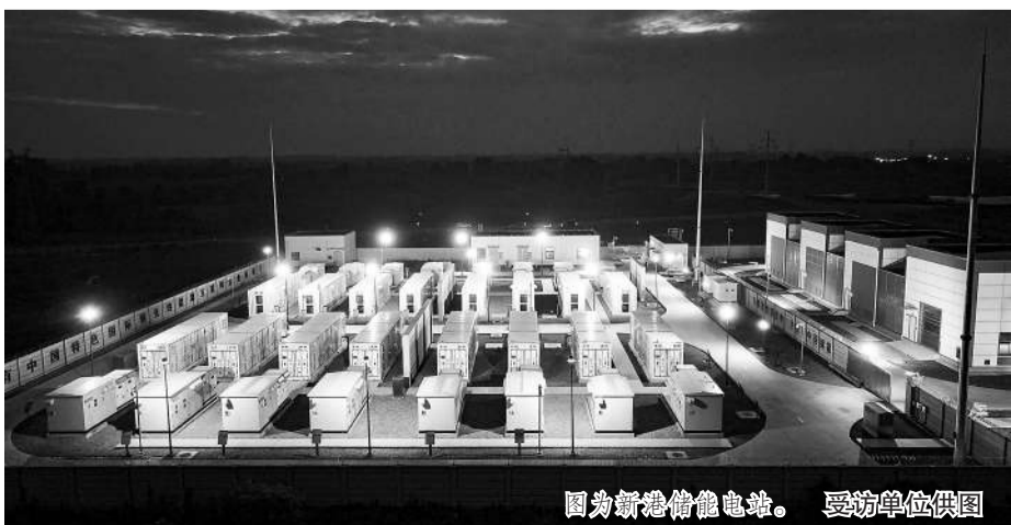
图为新港储能电站。 受访单位供图
