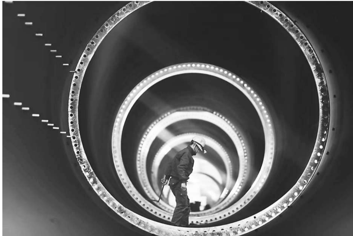
在渭南高新区陕西紫光装备股份有限公司内，工作人员正在忙碌。
