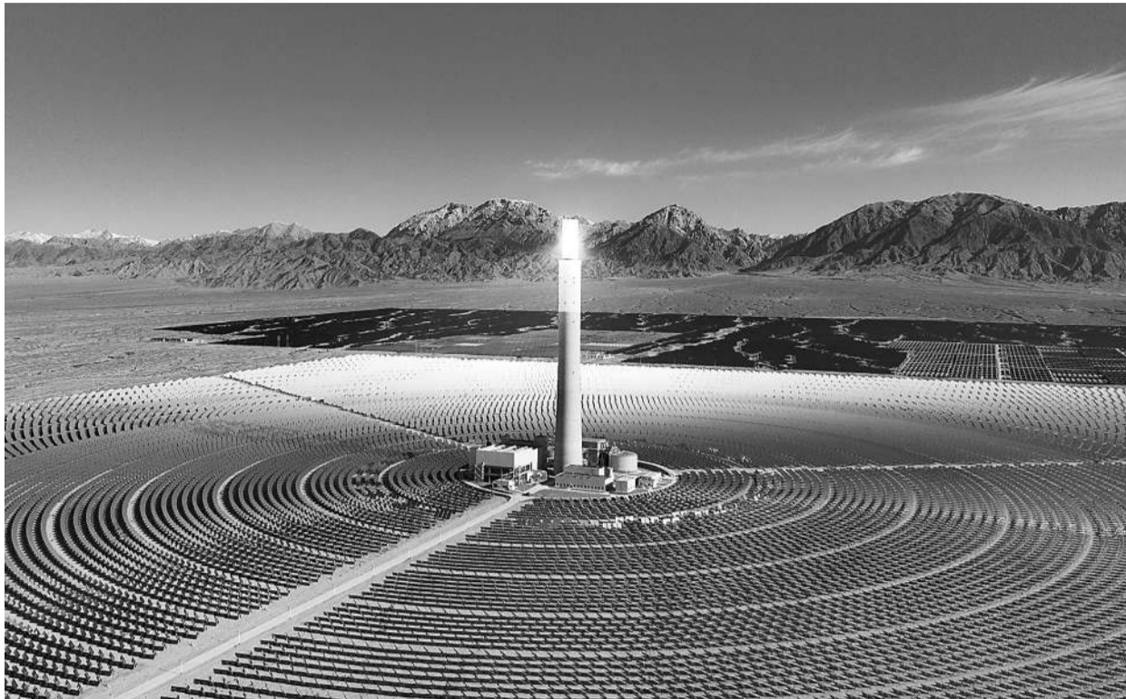
德令哈市光伏(光热)产业园的定日镜和吸热塔。新华社记者 张龙摄
