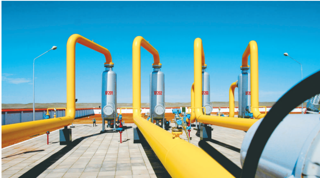
利用油气管网国产SCADA系统,远在千里之外的油气管网设备实现“无人操控”。
