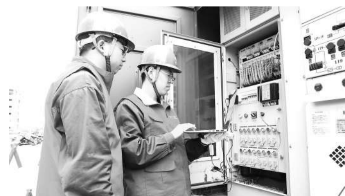
国网晋城供电公司员工对“自愈”配网线路进行调试。受访单位供图
