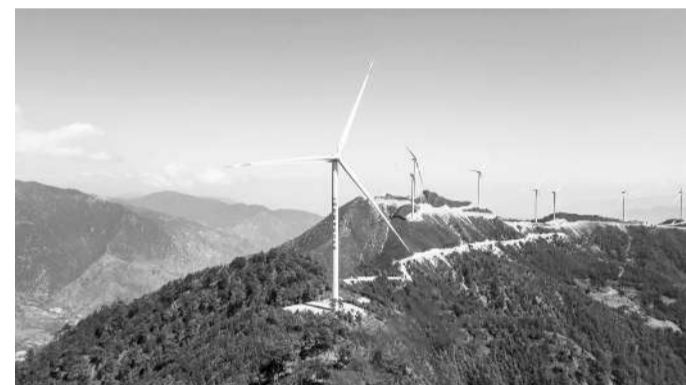
图为雅砻江腊巴山风电项目风电机组。该项目是雅砻江流域水风光一体化基地的组成部分。受访者供图
