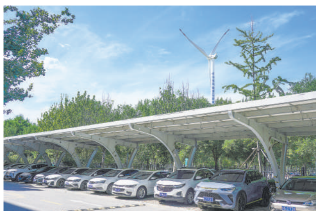
北京金风科技亦庄智慧园区是北京绿色交易所认证的“碳中和”智慧园区。图为园区内配有光伏设备的停车区,远处是风力发电设备。新华社记者 彭子洋摄
