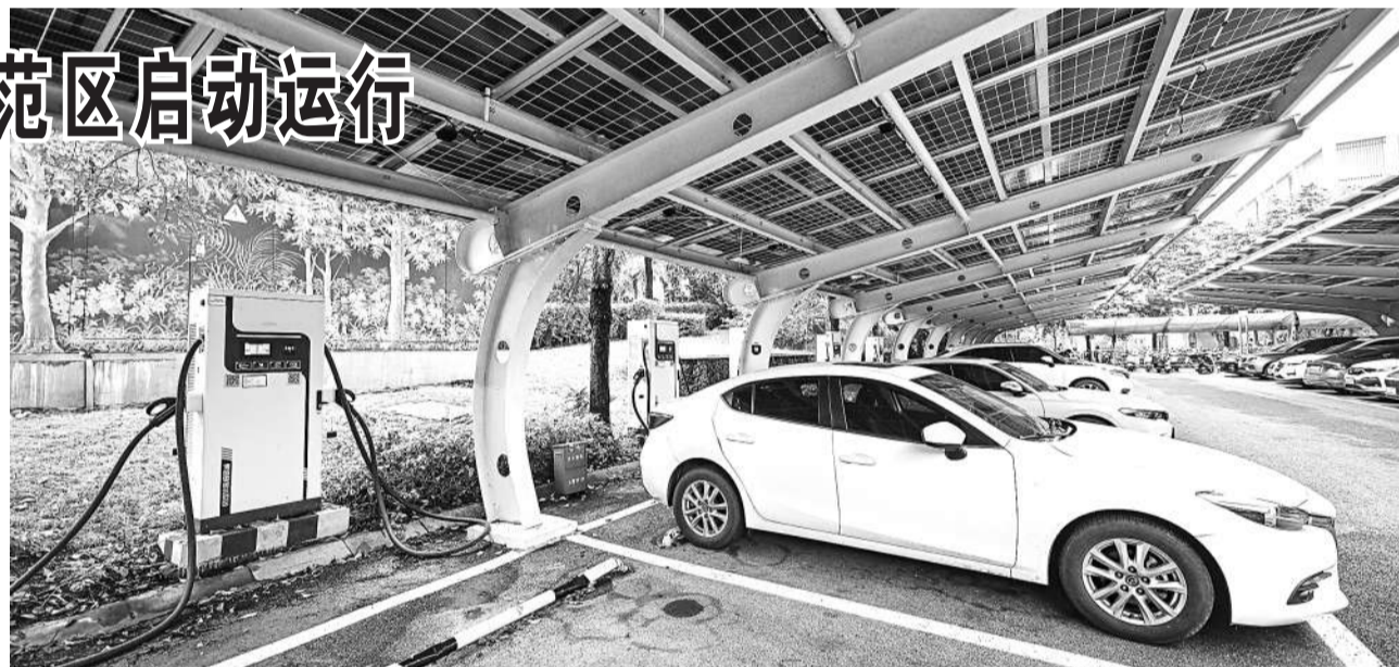
图为在博鳌近零碳示范区拍摄的建有光伏发电设备的停车场和新能源充电桩(3月9日摄)。新华社记者 蒲晓旭摄
