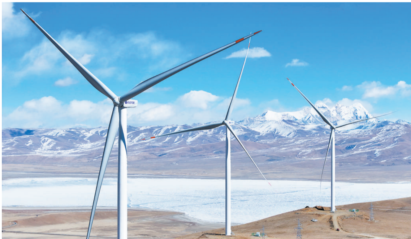
图为世界海拔最高风电场措美哲古风电场一角。三峡集团供图
