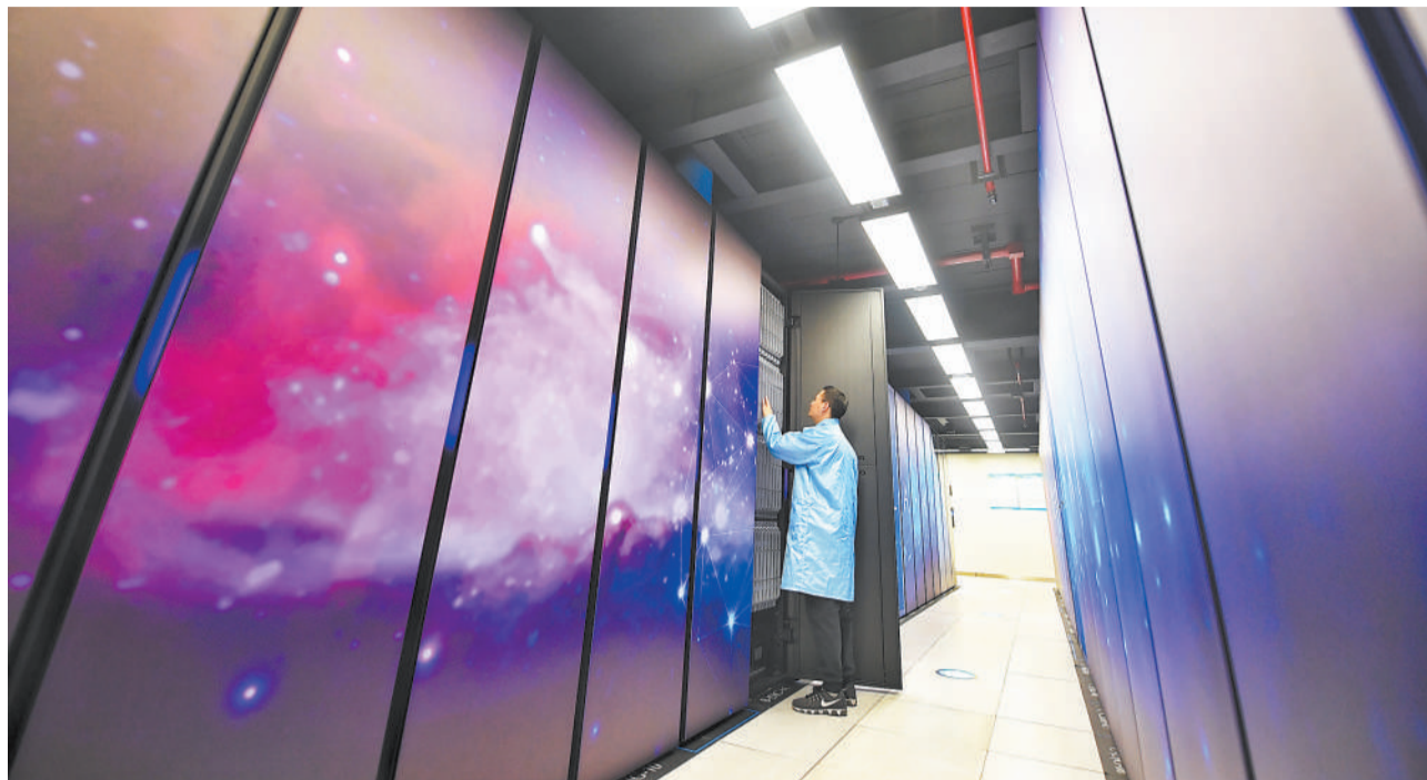
成都超算中心科研人员在巡检机房设备。 新华社记者 刘坤摄
