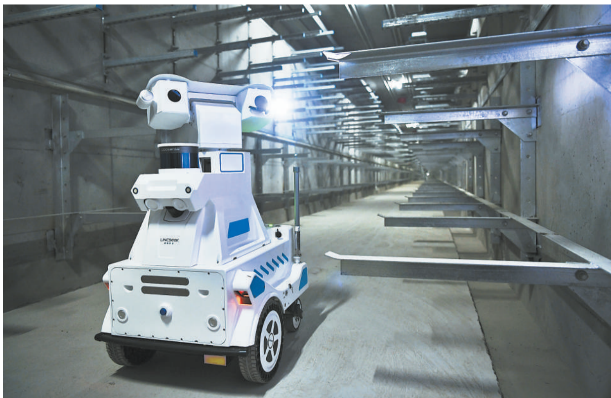
图为巡检机器人在地下综合管廊内进行技术调试。
