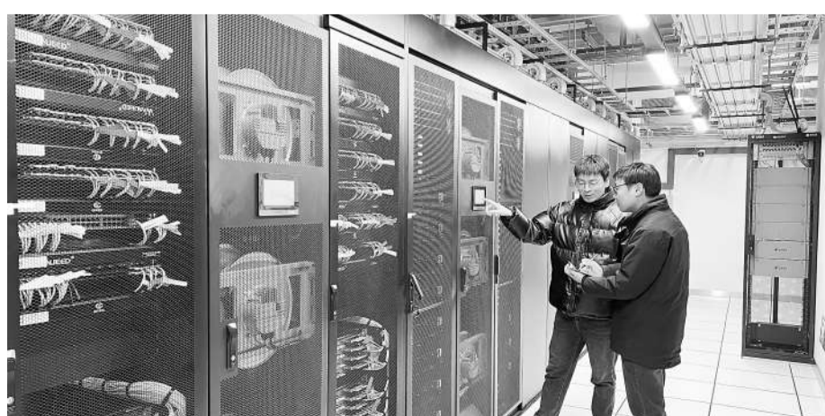
工作人员在中国电信中部智算中心内调试设备。
