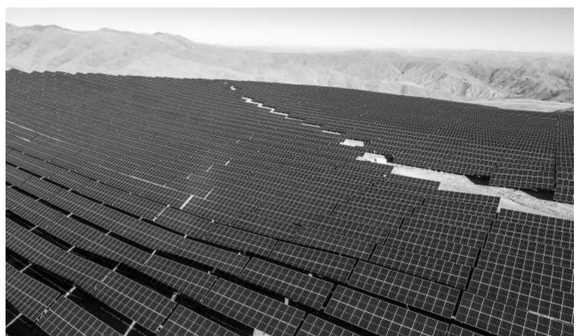
西藏才朋光伏电站位于山南市乃东区亚堆乡,占地面积 800 余亩,是目前世界海拔最高的光伏发电项目。近日,才朋光伏项目实现全容量并网发电。图为西藏才朋光伏电站(1 月 15 日报,无人机照片)。新华社记者 旦增尼玛曲珠摄
