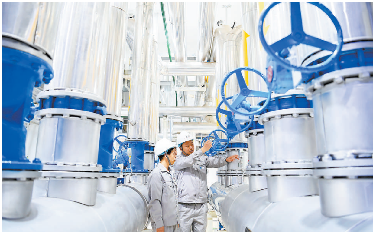
中国石化集团新星石油有限责任公司雄安地热站员工对地热装置进行维护保养。
