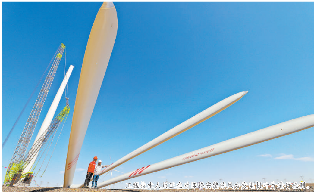
工程技术人员正在对即将安装的风力发电机叶片进行检测。
