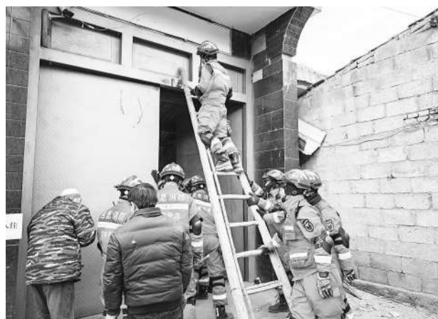
图为12月21日,消防救援人员帮助积石山县大河家镇韩家村群众排除房屋安全隐患。 本报记者 颜满斌摄
