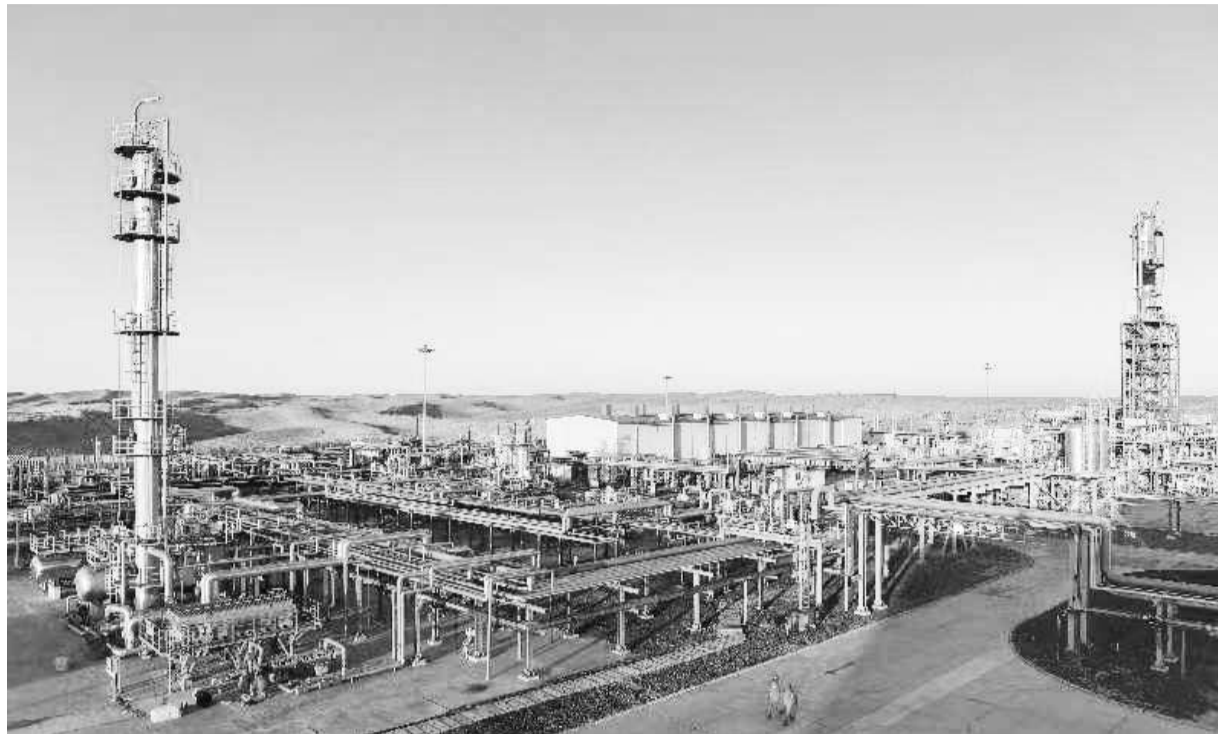
图为新疆油田采气一厂克拉美丽采气作业区天然气处理站全景。 蒋剑摄
