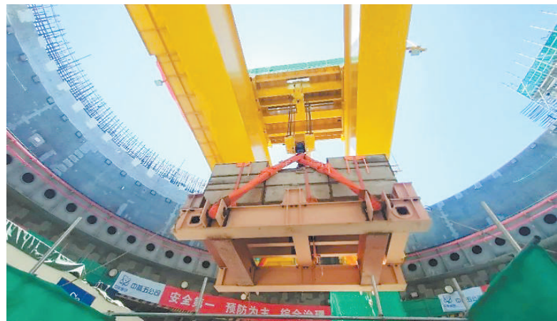
“玲龙一号”全球首堆环吊85T钩头完成载荷试验。受访单位供图
