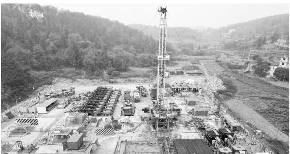
江汉石油工程井下测试公司焦页5-1HF井重建井筒重复压裂施工现场。 陈铭摄
