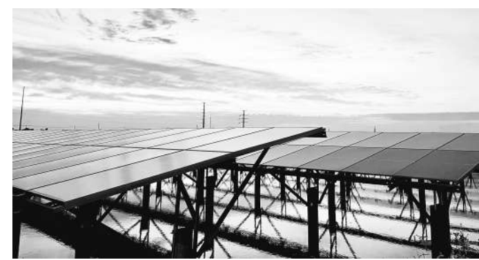
图为中广核上海崇明港西渔光互补光伏发电项目。 中广核供图
