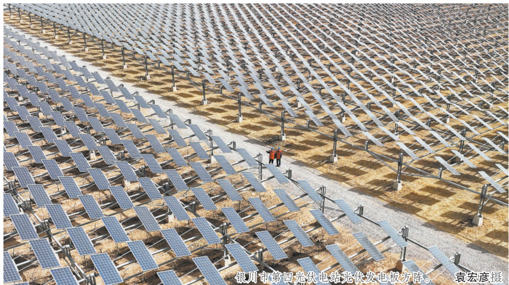
银川市第四光伏电站光伏发电板方阵。 袁宏彦摄
