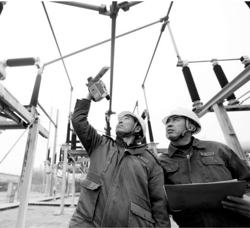
2月27日，国网山东安丘市供电公司员工利用红外测温仪，对110千伏汶河变电站设备测量“体温”，通过科技手段全面掌握设备“身体状况”，预防“发烧”隐患，确保变电设备健康运行，客户安全用电。图为工作人员在检测变电站设备。 李文博/摄 本报记者 陈瑜/文
