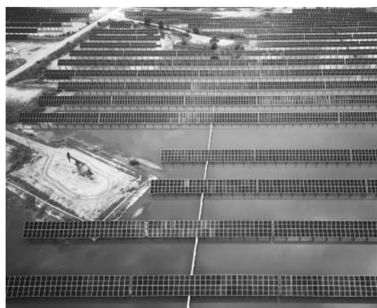
日前，中国石油首个水面光伏项目——大庆油田星火水面光伏示范项目完成自主设计建设水面光伏的成功探索，实现并网发电。据介绍，该项目利用两个水面，建设用地40万平方米，装机容量18.73兆瓦、年均发电2750万千瓦时，减排二氧化碳2.2万吨。 图为7月21日拍摄的大庆油田星火水面光伏项目(无人飞机照片)。 新华社记者 张涛摄
