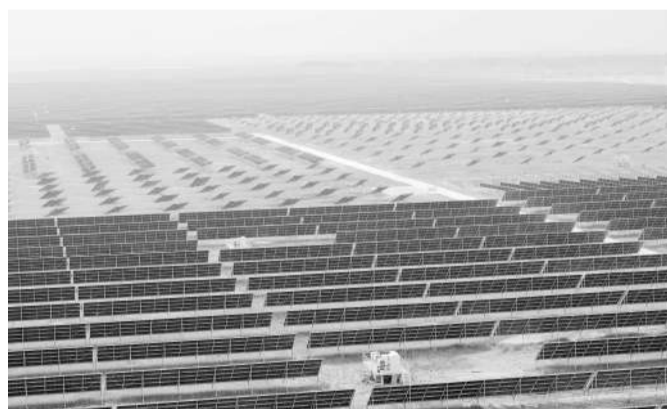
国家光伏、储能实证实验平台(大庆基地)。
