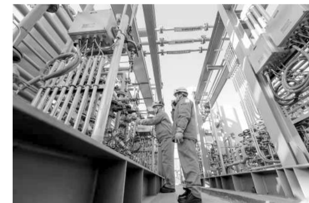
图为燕山石化职工保障氢气新能源装置安全平稳运行,确保冬奥用氢。受访者供图
