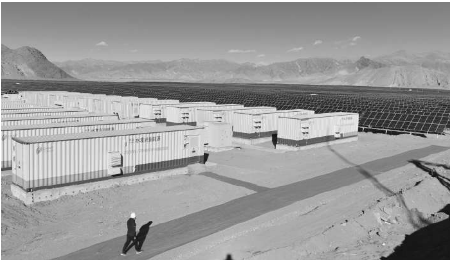
日喀则市江当现代生态产业园内的50兆瓦光伏储能系统和太阳能光伏组件 新华社记者 张汝锋摄
