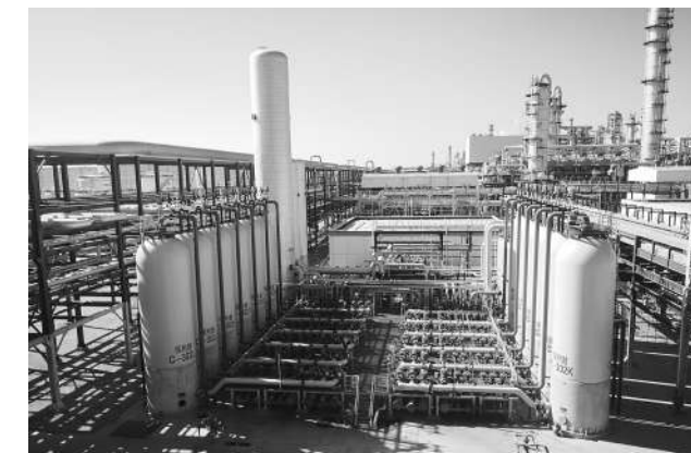
图为泉州石化二期项目配套的大型变压吸附装置 受访者供图
