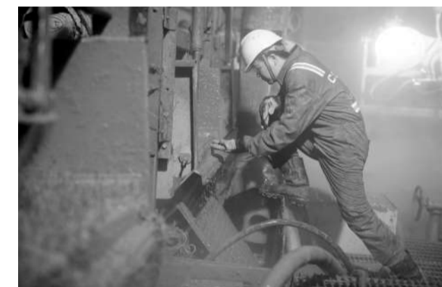
作业人员在现场对深水恒流变合成基钻井液进行检查 中海油田服务股份有限公司供图
