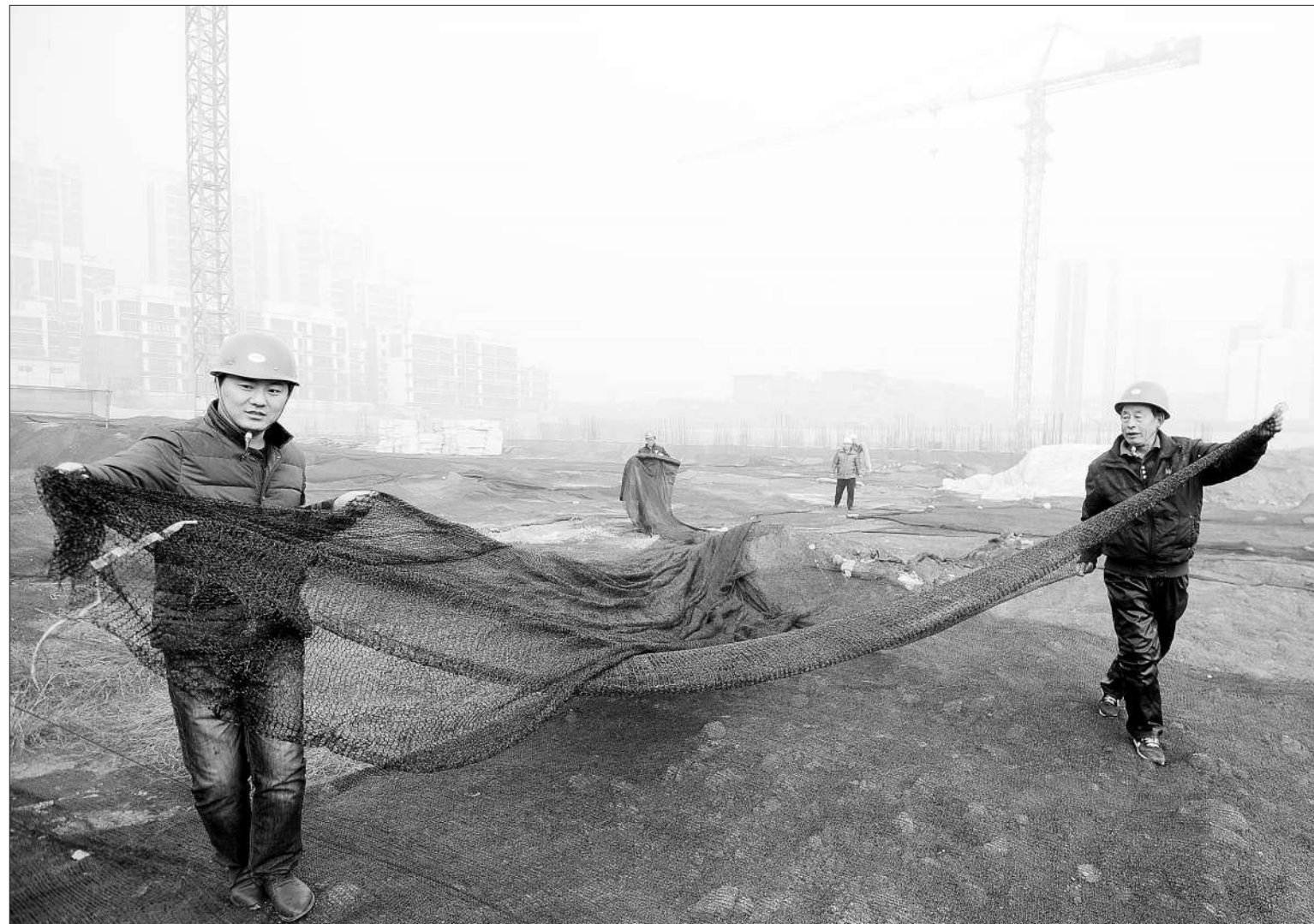
河北省派出多个督查组赴各地对应急预警措施落实情况开展督查,各级环保部门同时开展区域性督查,严格落实机动车单双号限行、建筑工地停工、污染企业减排等强制性措施,多措并举应对空气重污染。图为12月18日在河北省邢台市一停工工地,工人对工地防尘网进行日常加固。新华社记者 朱旭东摄
