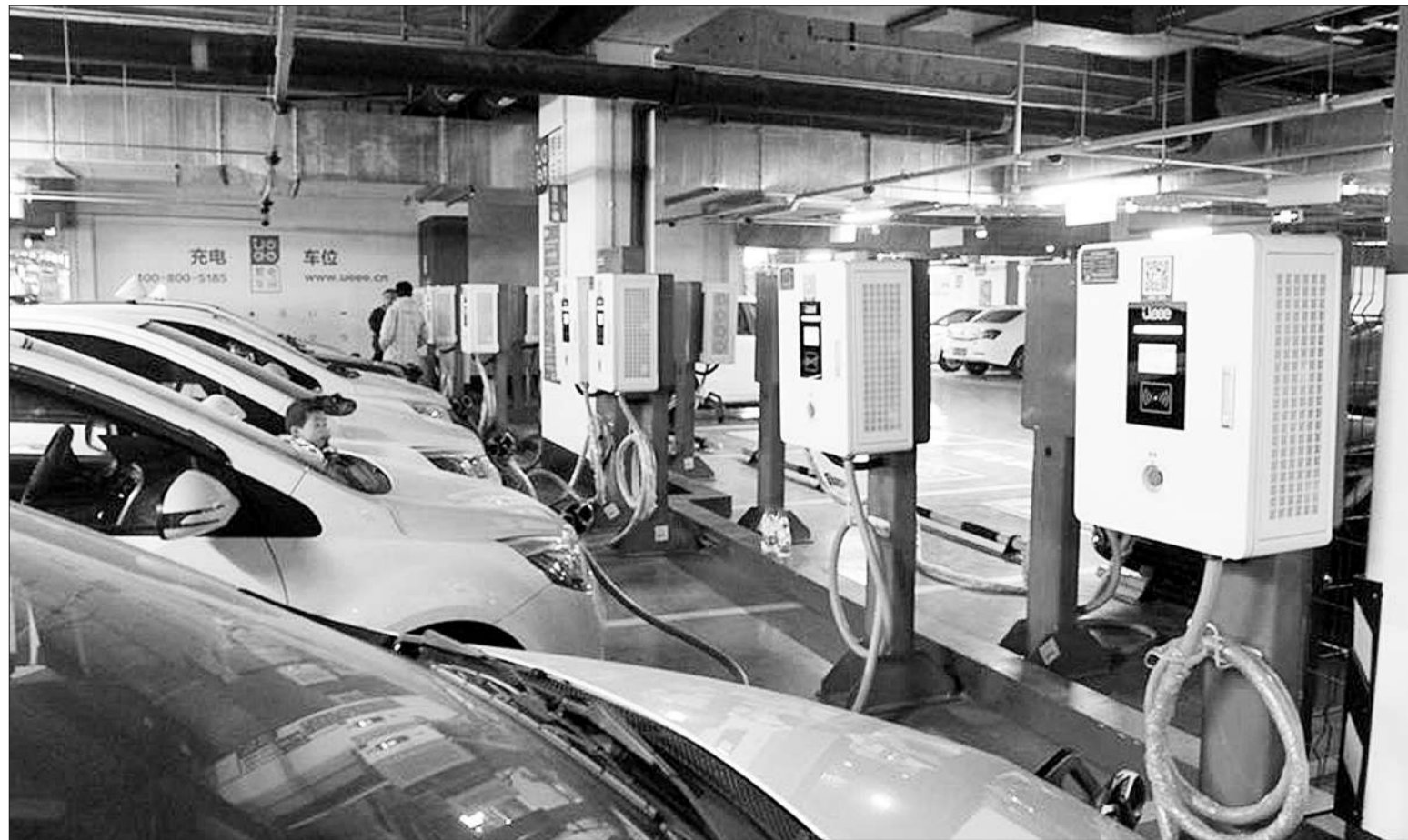
历经三个月的建设,北京荟聚中心地下停车场充电站首批55个充电桩近日正式投入使用,包括17台快充和38台普通交流桩。这一超级充电站共计158台充电桩,快充和慢充比例1:1,建成后将成为亚洲最大的电动汽车公共充电站,有望缓解电动汽车充电难题。该充电站将使用便捷性放在了首位,可以通过App、e充网甚至微信等多个渠道实现充电和缴费。
