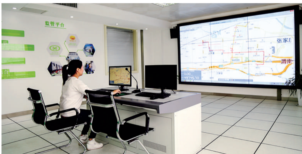
渭南高新区新能源汽车监控中心
