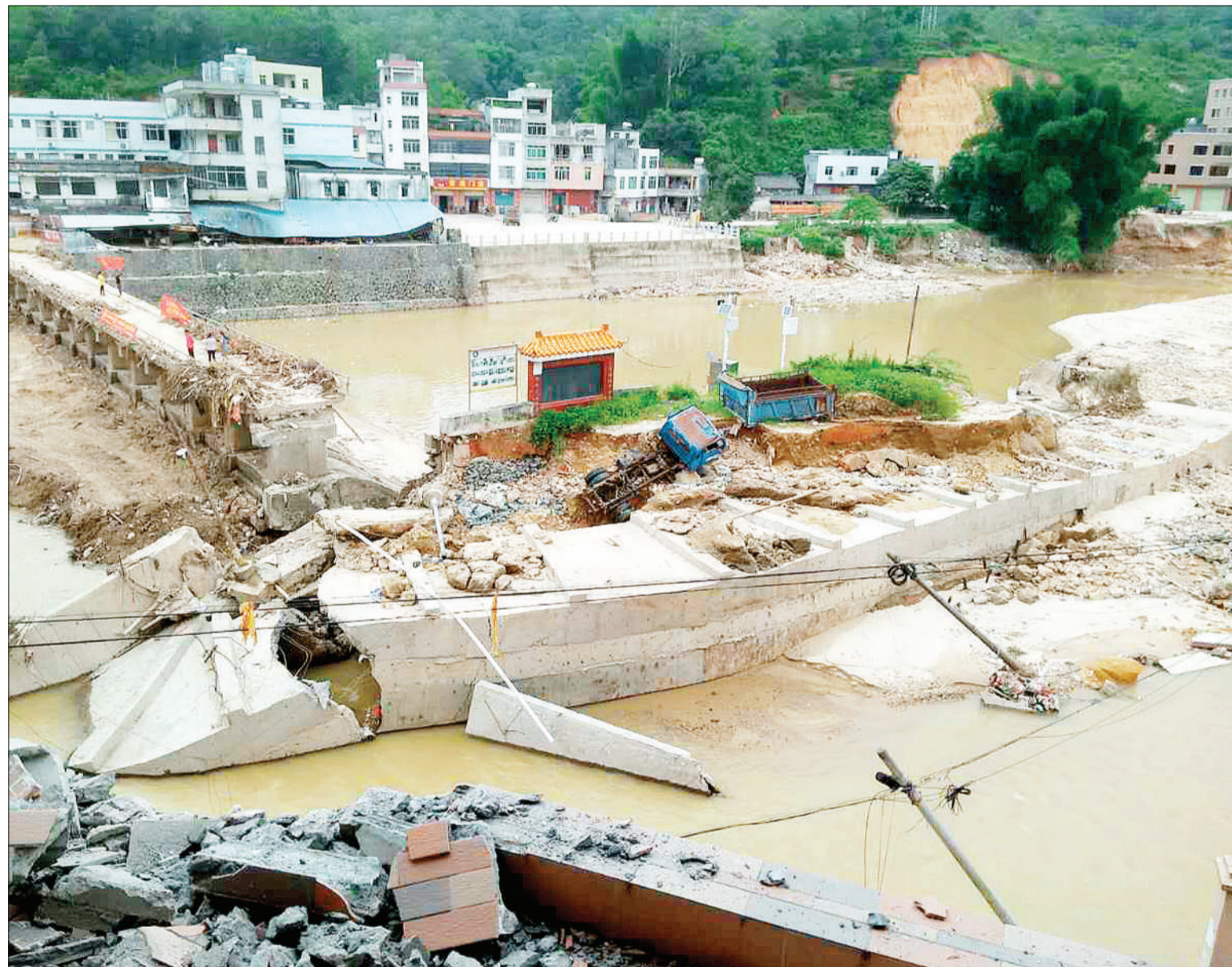
5月23日，广东茂名信宜市洪水退去，留下的是被洪水冲垮的桥梁和被山洪泥石流推倒的山村楼房。
