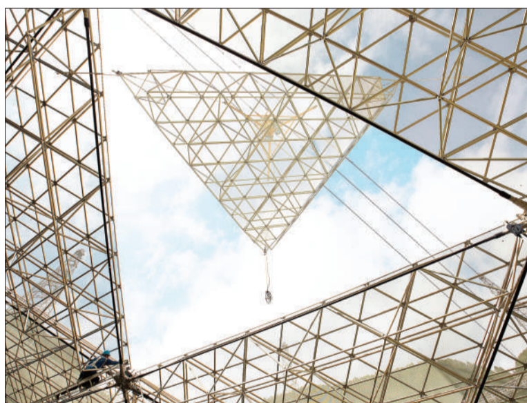
11月21日,500米口径球面射电望远镜(FAST)目前正在进行反射面板安装,4400块边长约11米的三角形面板安装已经完成近三成。
