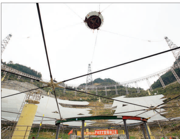
11月21日,6根钢索拖动球面射电望远镜(FAST)馈源舱进行功能性测试。
