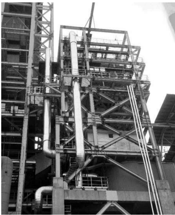
大唐洛阳热电厂#5机示范装置
