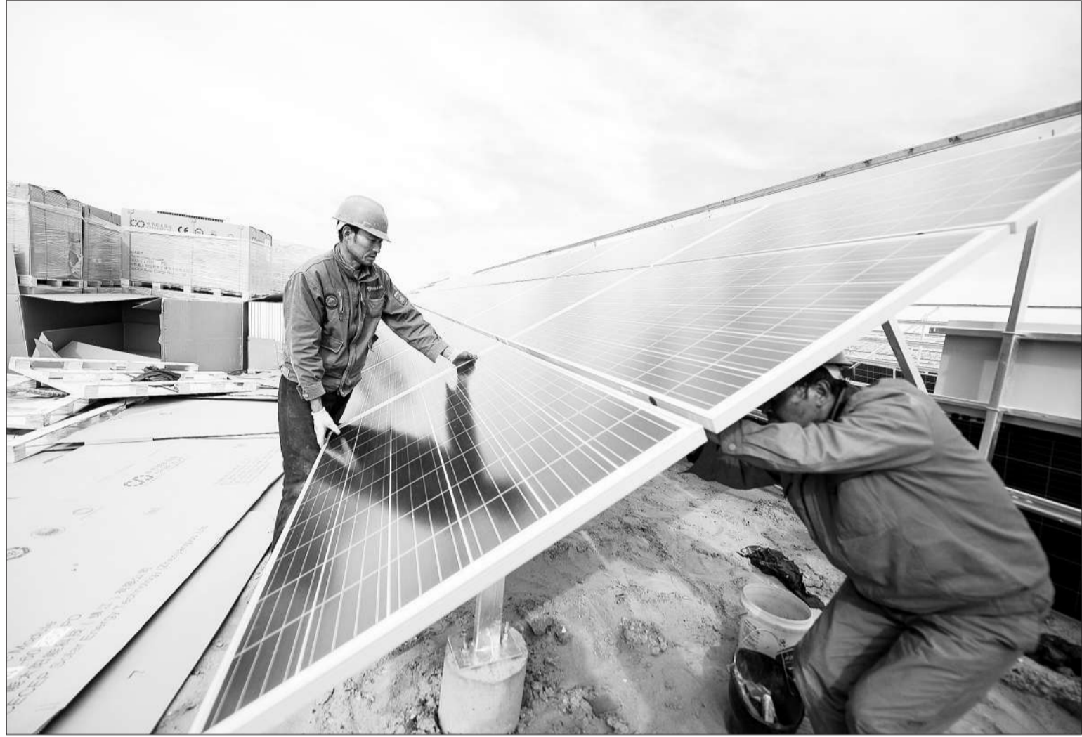
9月6日，两名工作人员在青海格尔木光伏产业园区安装太阳能电池板。据青海省格尔木市海西州能源局最新数据显示：今年格尔木市继续加大光伏基地建设，将新增太阳能光伏发电装机容量600兆瓦。今年项目完成后，格尔木市的光伏发电总装机容量将达到2300兆瓦。
