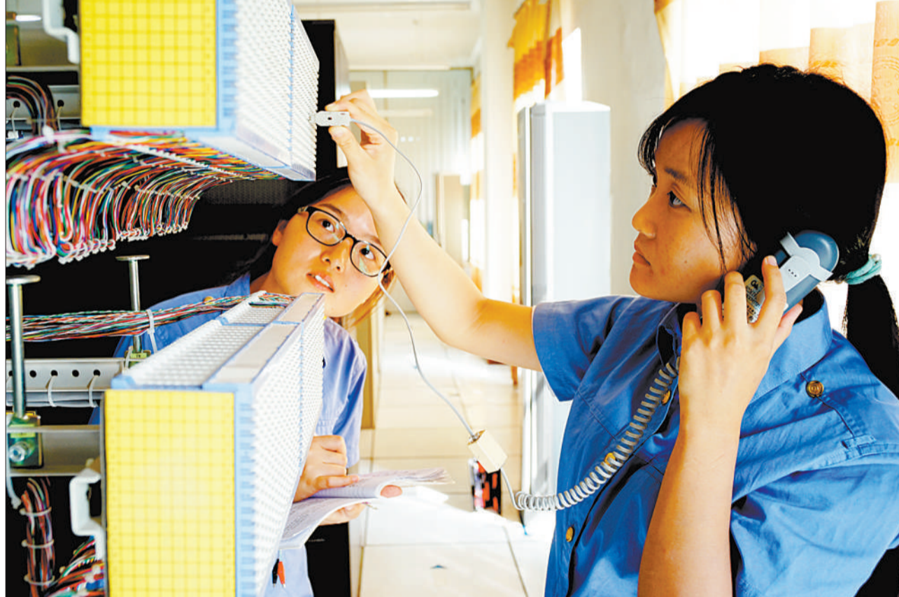
为保障2015年暑运期间的顺利通行,武汉通信段恩施车间承担宜万线铁路288运营公里及368个通信机房的... 铁路通信以及其他相关设备的维修养护任务,并实时监控管内宜万线隧道、桥梁预警,提高职工的业务技能,做好... 宜万线的“千里眼”。图为职工在调试设备。 本报记者 周维海摄
