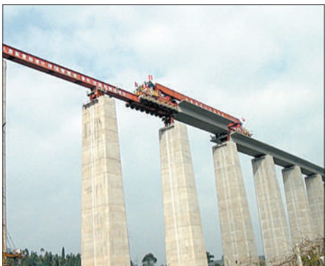
阶段。 铺架和无砟轨道施工进入最后攻坚的云桂铁路云南段六标工程的土建、近日,由中铁十八局五公司承建
