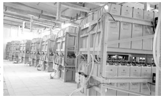
中广核青海共和县18MWh管式胶体铅酸电力储能系统
