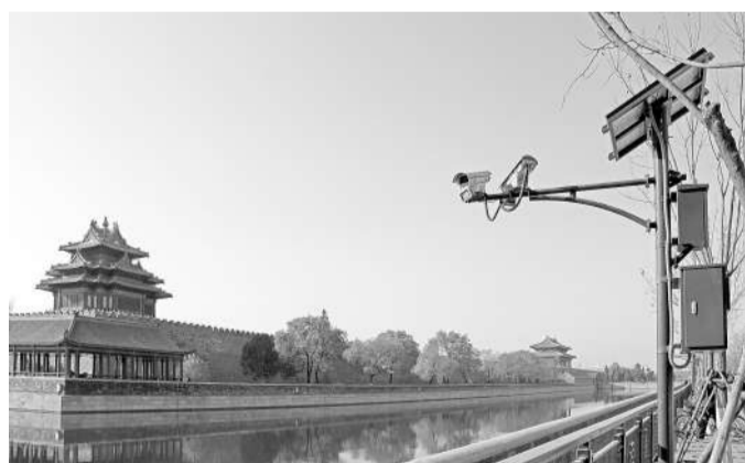
太阳能无线监控系统
