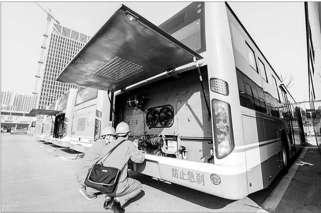
11月26日,长兴县供电公司的工作人员在检查纯电动公交车的充电、蓄电池设备,为正式投运做好准备。 当日,浙江省长兴县首批10辆纯电动公交车在长兴县画溪公交枢纽站正式投入运营;10个配套充电桩也检测完毕,可同时满足10辆公交车充电。据悉,这批纯电动公交车全部依靠电机、电池来为车辆运行提供能量,具有无污染、低噪音、稳定性高等特点。长兴县成为浙江省首个使用纯电动公交车的县级城市。 新华社记者 徐昱摄
