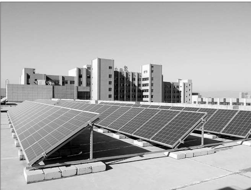
华北电力大学微电网的屋顶光伏系统
